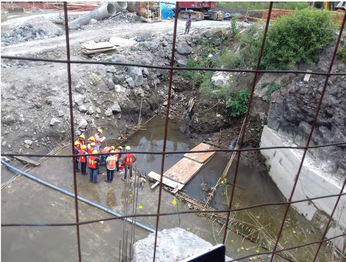
En el predio de Aztecas 215, donde las excavaciones de una constructora hicieron que aflorara un brote de agua del acuífero somero.
