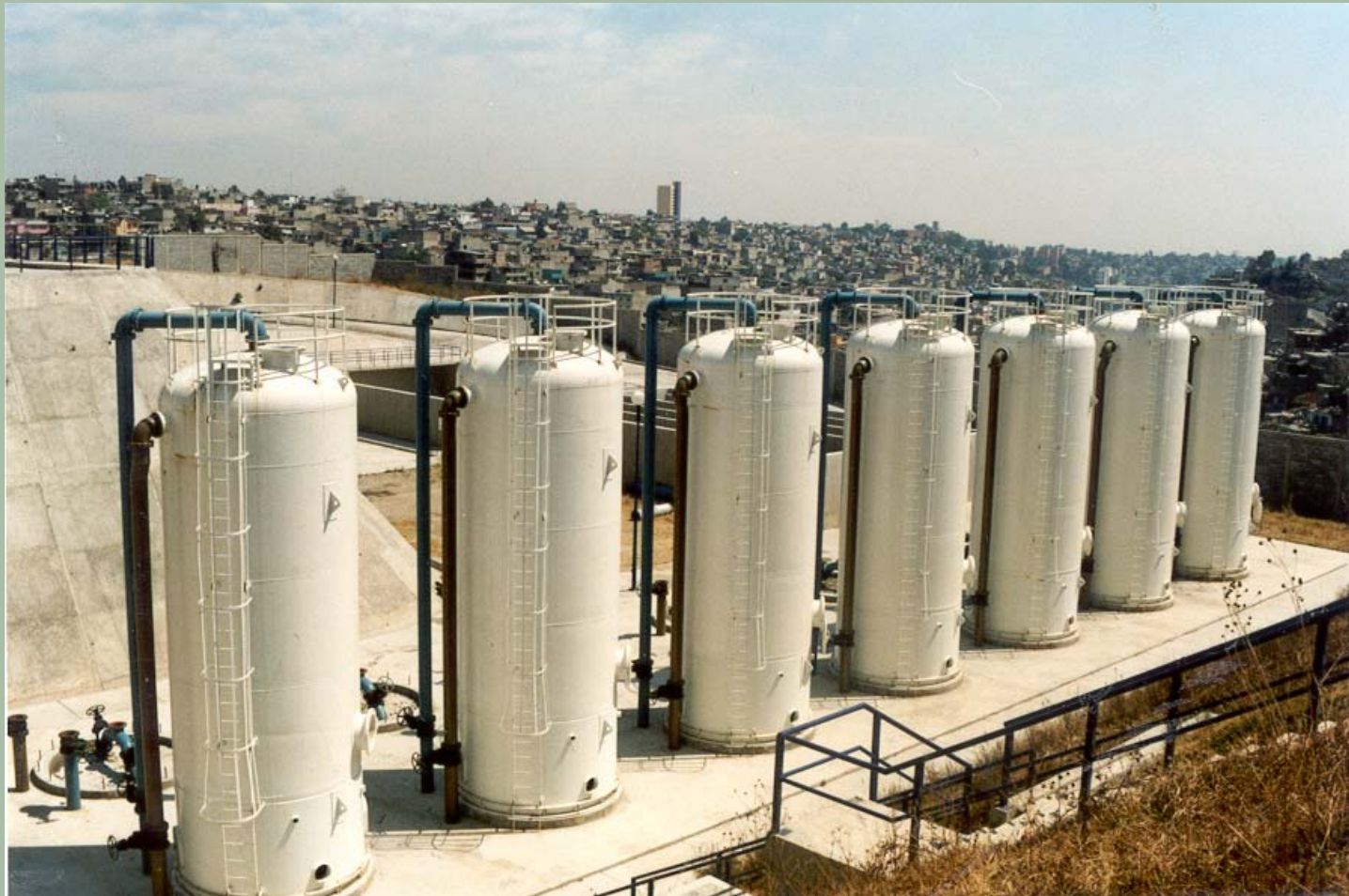
Planta de tratamiento de aguas residuales, Santa Fé
