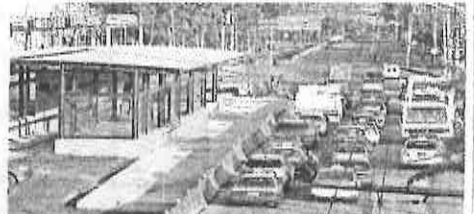
La construcción de la Línea 6 del Metrobús muestra los mayores avances en las estaciones, las cuales serán 37 en total.
