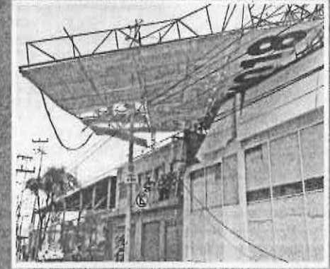
NO AGUANTÓ. Un espectacular cayó sobre cables de luz en calzada Vallejo y Poniente 126.
