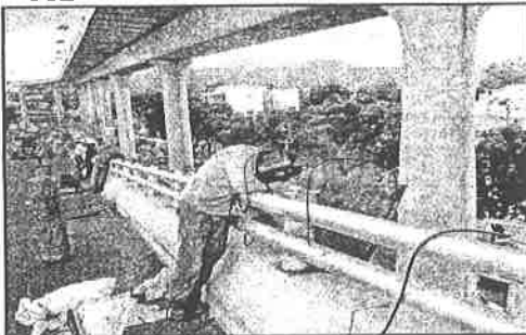
El segundo piso para salir a Cuernavaca entró en operación a las 5:00 horas de hoy. Será gratis durante siete días.
