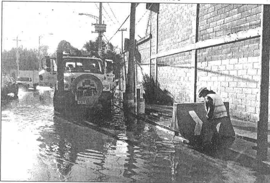
Trabajadores drenan el agua acumulada debido a una fuga ocurrida ayer en la calle Añil, a la altura de la puerta 15 de la Ciudad Deportiva, delegación Iztacalco ■ Foto Víctor Camacho
