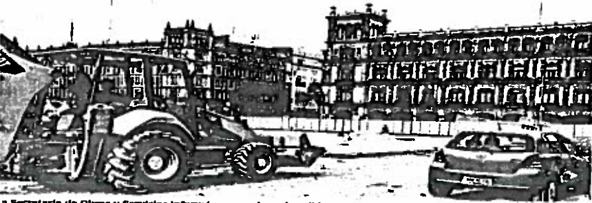
La Secretaría de Obras y Servicios informó que por la mala calidad del aire desde la tarde del lunes 15 de mayo se suspendieron los trabajos con maquinaria en cada uno de los proyectos a su cargo.
