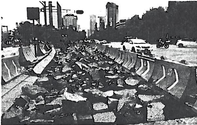
Una primera acción constructiva iniciada por las autoridades capitalinas fue el cambio de carpeta de rodamiento para el Metrobús, pero la obra fue suspendida porque podrían afectar el basamento de algunas de las estructuras de los héroes sobre Paseo de la Reforma.
