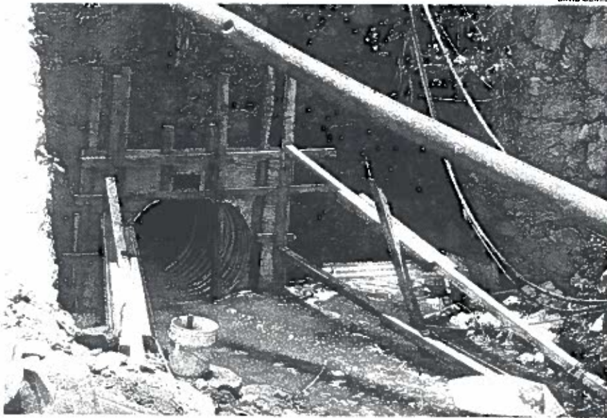
Se busca evitar filtraciones de agua que vuelvan a socavar la tierra que está debajo de la carretera.
