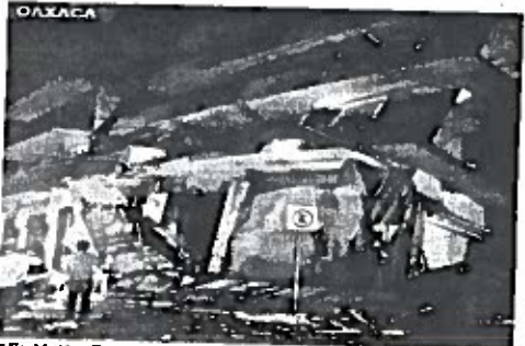
En Matías Romero, un hotel se colapsó sin que se reportaran víctimas mortales.
