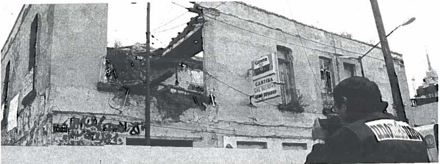
Estas construcciones quedaron severamente dañadas por el sismo registrado el pasado jueves.
