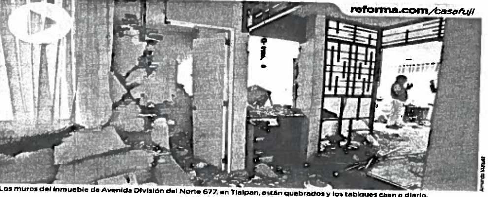
Los muros del inmueble de Avenida División del Norte 677, en Tlalpan, están quebrados y los tabiques caen a diario.
