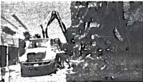
Cada uno de los inmuebles contará con un proyecto de demolición y un expediente que dé certeza jurídica a las actividades.
