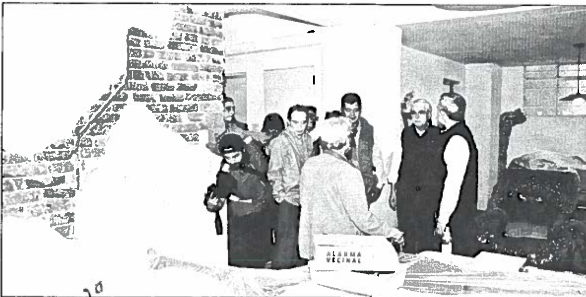
El jefe de Gobierno, Miguel Ángel Mancera Espinosa, conoció los trabajos de rehabilitación que se realizan en el edificio de Río Tigris 22, colonia Cuauhtémoc, el cual presentó daños en departamentos de cuatro de los siete niveles ■ Foto La Jornada
