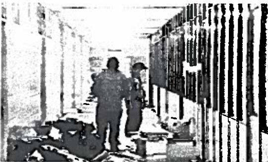
Trabajadores iniciaron ayer con labores de limpieza para luego comenzar a derribar
