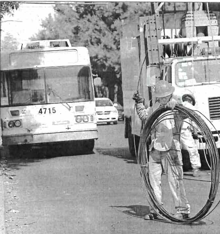
En diciembre pasado, las líneas G y LL del Servicio de Transportes Eléctricos Trolebús se quedaron sin servicio por el robo de cable. Aquí, trabajadores durante la reinstalación del cableado ■ Foto Víctor Camacho
