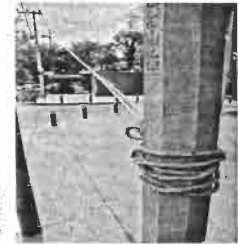
Las cableras incumplen con el retiro del cableado.
