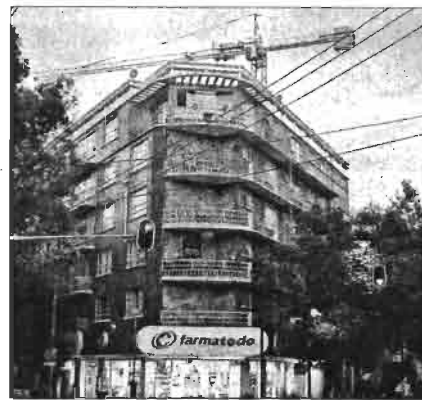
El edificio Sevilla 710 presenta daños.
