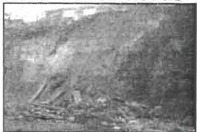
Las fuertes lluvias que azotaron ayer a la capital, ocasionaron inundaciones y un deslave en un conjunto residencial en Insurgentes Sur 4411, cerca de la Joya.
