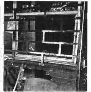
Algunos de los daños.
